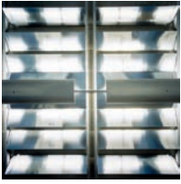
Indirekte Bürobeleuchtung über Breitbandreflektoren.
