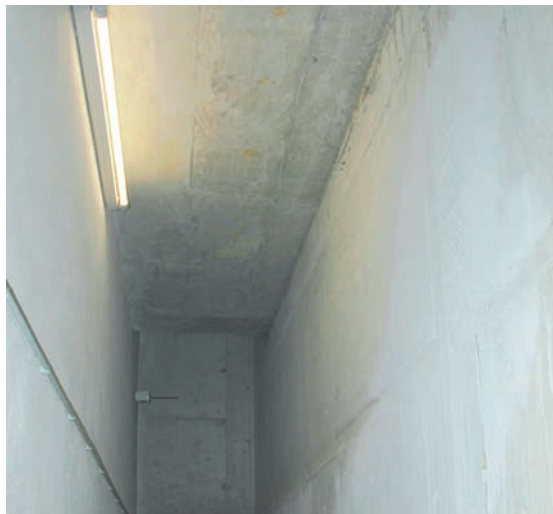
Der Blick in den mehr als 90 Meter langen Erdkanal zur Klimatisierung der Schweinfurter Büroräume mittels Erdwärme und -kühle.
