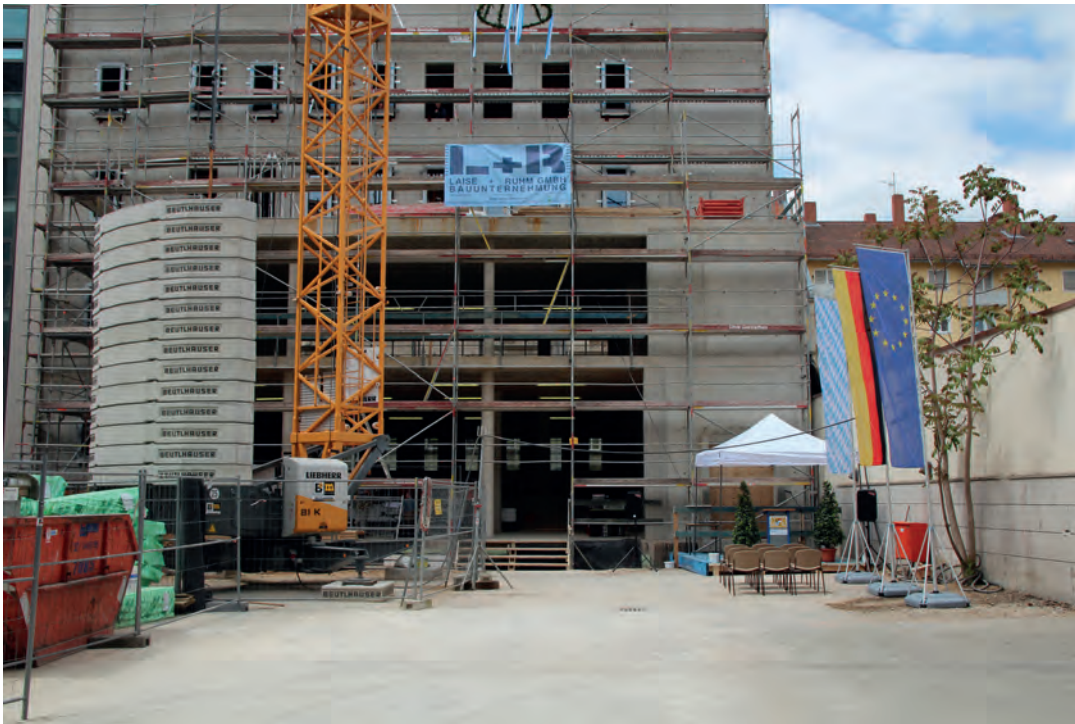
Der Bauteil F am Tag des Richtfests: In Kürze werden hier Mitarbeiterinnen und Mitarbeiter des Landesamts ihre Arbeit aufnehmen.
